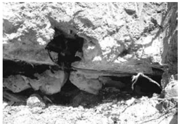
Sl. 2 - PDŽS, ostaci drvenog roštilja, uvećano (Projekat rehabilitacije „Podgradska džamija u Stocu“)
